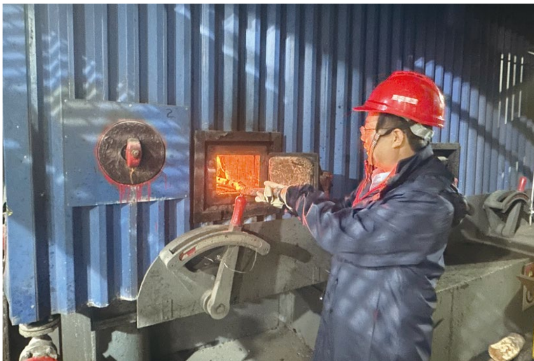
能源热电集团铁路红宇和金港供热站应急备用燃煤锅炉紧急启运
